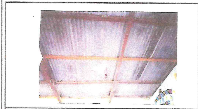
Foto 3: Láminas en mal estado
