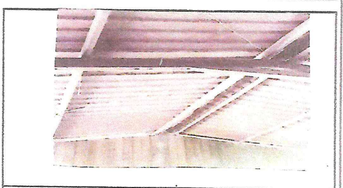
Foto 6: Lámina en mal estado
