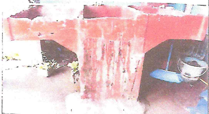
Foto 4: Pila en mal estado
